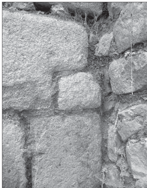
Obr. 4. Hrad Lukov, detail jižní fasády západního pylonu – čtvercový otvor zaslepený kamennou plombou. Foto R. Vrla, 2005.
