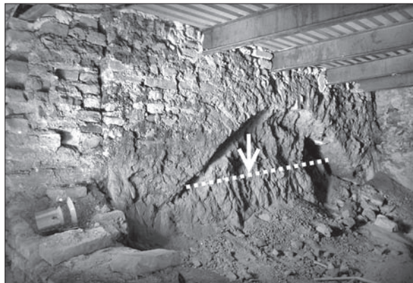
Obr. 7. Statický základový oblúk pod renesančnou priečkou. Šípka a bodková čiara označujú polohu rozhrania medzi rastlým terénom – sprašou a nesúdržným zásypom. Foto P. Grznár, M. Zelina.
