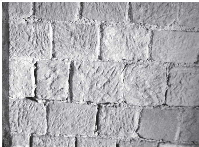
Obr. 10. Múr vo veži hradu Šomoška z 13. až 14. storočia má pieskovcové kvádre, nepravidelne upravené dvojšpicom (Zweispitz). Foto D. Pivko.
