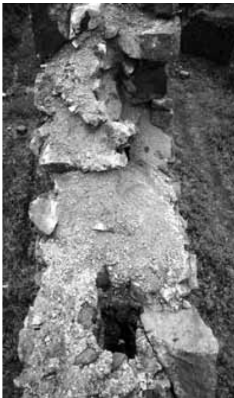
Obr. 10. Šumberk (okr. Chomutov). Rozvolněná koruna zdiva s vyústěním šikmých pásků, mladší obezdění dřevěné konstrukce překrývá ještě zčásti otvor po jednom z pásků. Foto I. Peřina, 2007.
