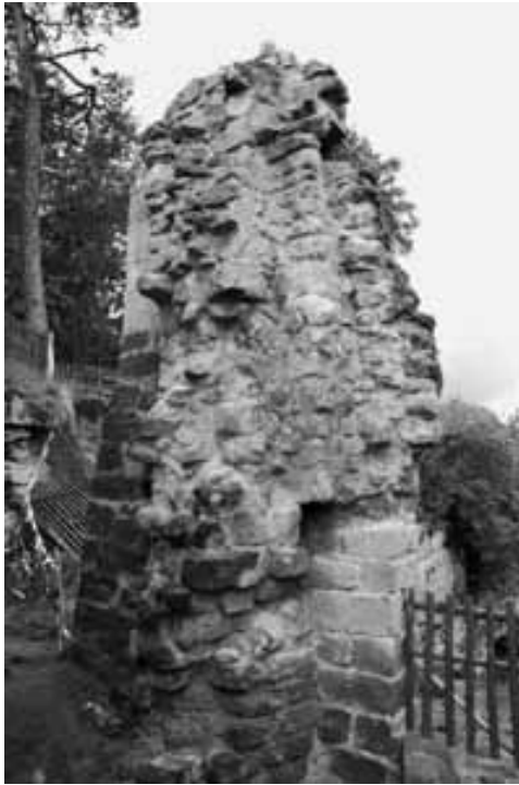
Obr. 5. Valdštejn (okr. Semily). Nároží stavby s výběhem zdiva východním směrem k starší zástavbě hradního jádra, v destrukci hloubkové obvodové zdi patrné kapsy po dolním i horním systému výztuh. Foto I. Peřina, 2007.
