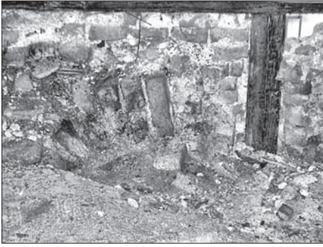
Obr. 6. Torzo pôvodného (?) okna v dnešnom podkroví. Foto J. Žuffová.
