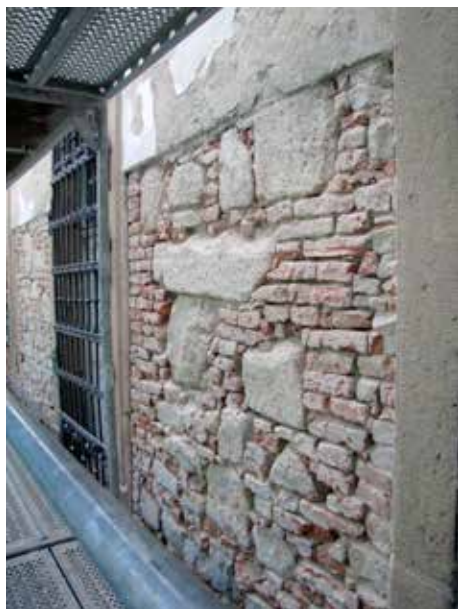
Obr. 2. Vizovice. Část spodní partie jižního průčelí zámku s obnaženou strukturou zdiva; v cihelném zdivu je použito velké množství starších architektonických detailů. Foto R. Vrla, 2013.
