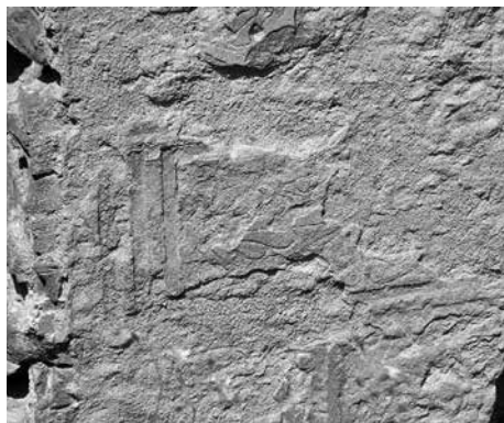
Obr. 7. Rabštejnec, k. ú. Smrkový Týnec, okres Chrudim. Poslední zbytky historizujících sgrafit. Stav z roku 2006. Foto J. Musil.
