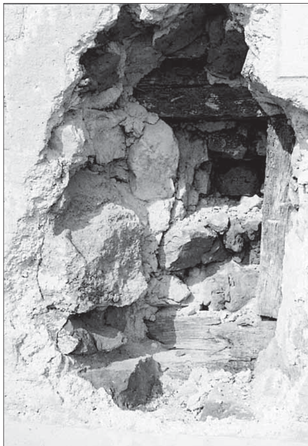
Obr. 3. Odkrytá strieľňa s dubovou výstužou na 1. nadzemnom podlaží kúrie. Exteriér. Foto Z. Ševčíková.
