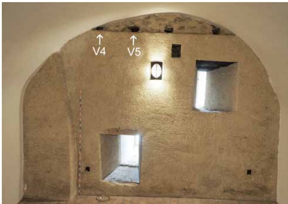
Obr. 5. Trenčiansky hrad. Južná stena 3. NP veže s vyznačením vzoriek stavebných drev. Foto M. Bóna. Abb. 5. Burg Trenčín. Südwand 3. OG des Turms mit Kennzeichnung der Bauholzproben. Foto M. Bóna.
