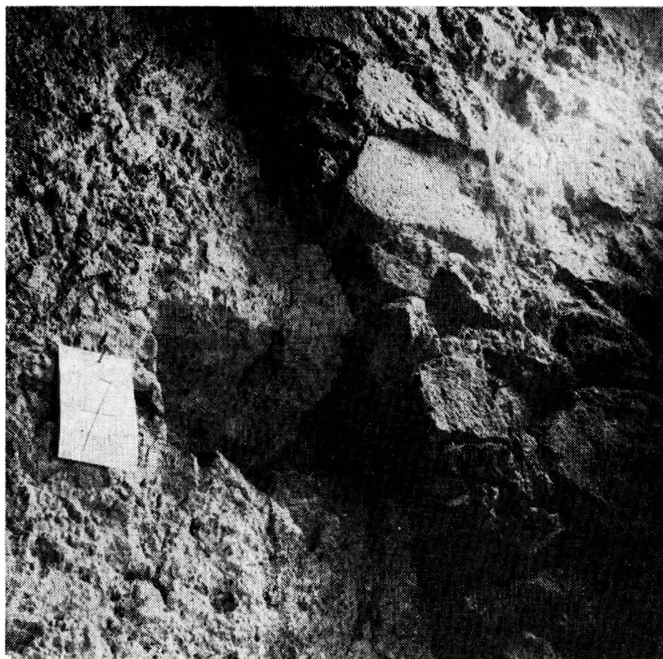
Obr. 8. Prepoštská 11 — kamenný podklenutý pás spodného podlažia objek- tu, druhej tretine 15. sto- ročia. Foto: V. Kamenická.
