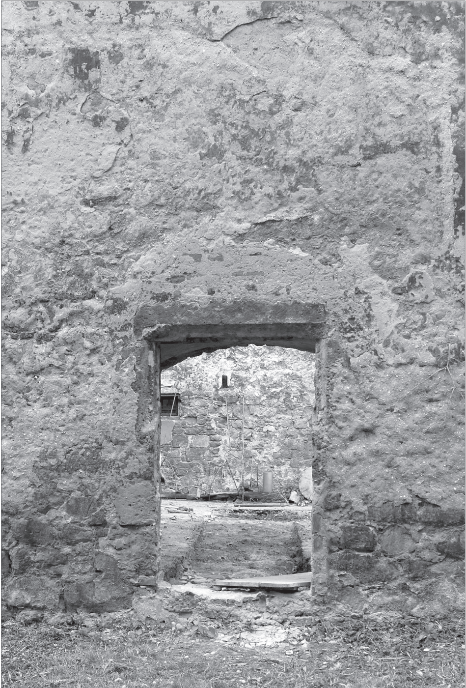
Obr. 2. Okenní otvor karlštejnského profilu upravený na dveřní otvor na severním průčelí severního křídla hradního jádra. Foto L. Kursová.
