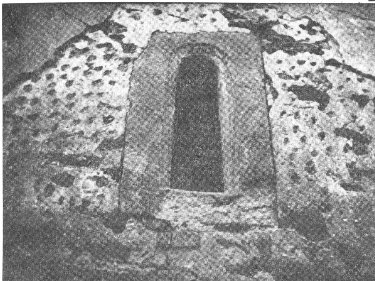
Obr. 5. ZSO Dolany (okr. Píseň-sever). Kostel sv. Petra a Pavla. 1 – svrchní část severozápadního opěráku lodi zakončená stříškou, 2 – okénko v západním průčelí se zbytky původní omítky v okolí. Foto autor.
