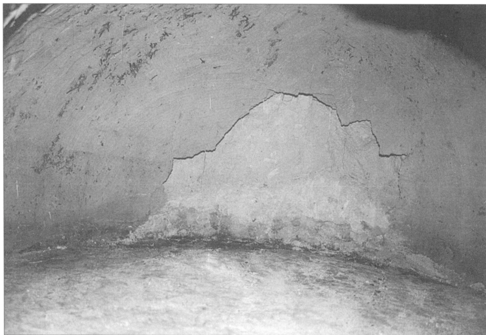
Obr. 9. Pohled na část dna a stěn spíže – obj. č. 83A, s patrnou tenkou vrstvou výmazu a tmavými spálenými rostlinnými zbytky přidaných do výmazu kopule. Foto J. Špaček.
