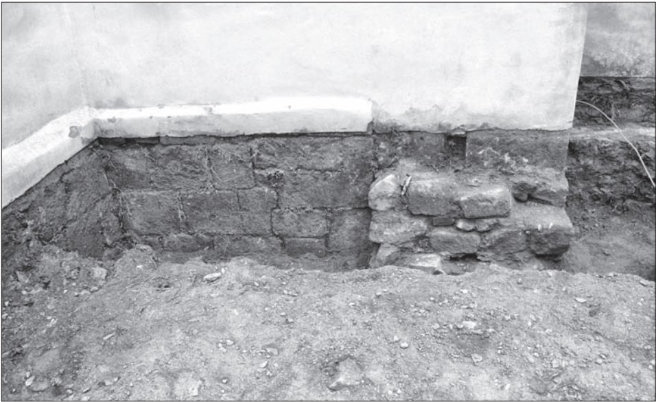
Obr. 7. Bukovec, okr. Domažlice, kostel Nanebevzetí Panny Marie. Západní stěna kostela. Vlevo zdivo románského průčelí, vpravo rozšířený předzáklad gotické lodi. Foto M. Čechura, 2009.
