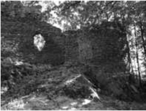
Obr. 3. Cimburk u Městečka Trnávky. Část západní zdi předhradí s dodatečně připojenou pozdně gotickou baštou. Foto J. Štětina, 2007.
