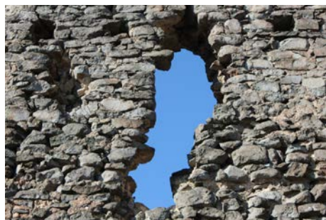
Obr. 16. Hrad Slanec, okr. Košice-okolie. Detail severovýchodnej steny paláca so zvyškom okna a lôžkami stropu pôvodnej budovy. Foto M. Šimkovic.
