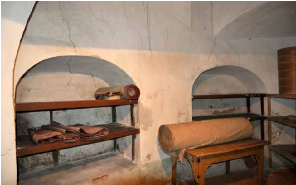
Obr. 19. Hrad Orlik, okr. Písek. Interiér někdejší kuchyně v prvním patře čelního křídla. Foto J. Varhaník, 2012.
