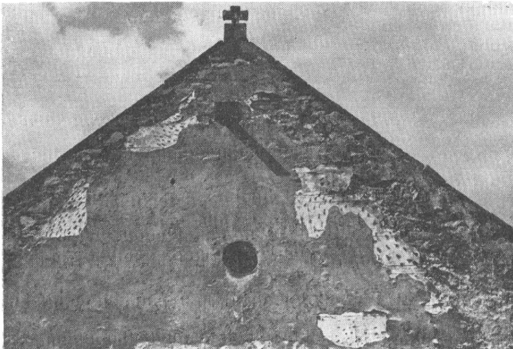
Obr. 10. Bolevec čp. 7. Východní štítová stěna sýpky s rýsovanou osnovou renesančního sgrafita pod opadanou omítkou.
