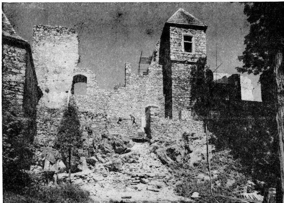
Obr. 1. Hrad Klenová u Klatov — příklad rekonstrukce nedávno zřícené části hradní kulisy, s vložením stabilizační dozdivky, pro níž byl hledán tvar, navazující na romantickou úpravu z 19. století.
