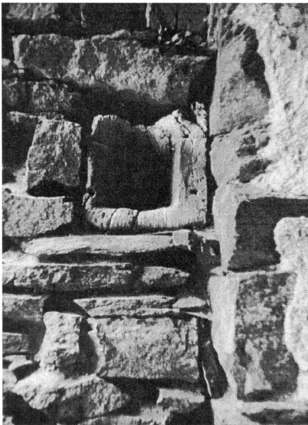
Obr. 10. Bítov, menší břitová věž severního předhradí. Kapsa pro závoru spodního vstupu, umožňující jej uzavřít zvenčí. Foto J. Noll 1994.
