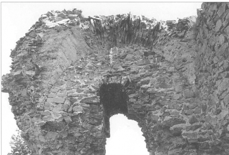
Obr. 5. Weikertschlag – zbytek klenby a narušené okénko v patě bergfritu.
