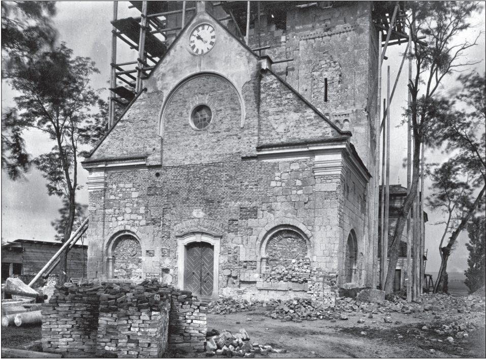
Obr. 10. Biňa (okr. Štúrovo). Bývalý premonštrátsky kostol počas rekonštrukcie realizovanej podľa plánov G. Cziglera v rokoch 1895–1898. Foto P. Gerecze. Forster Gyula Nemzeti Örökséggazdálkodási és Szolgáltatási Központ / Národné centrum Gyulu Forstera služieb a ekonomiky v oblasti kultúrneho dedičstva v Budapešti, sign. 63179PD.
