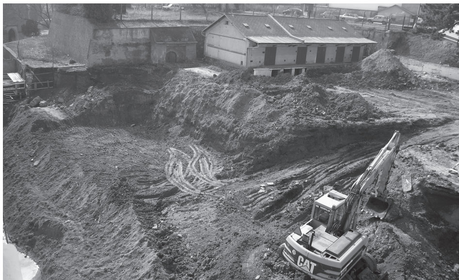
Obr. 17. Kutná Hora, jezuitská kolej. Jižní nádvoří. Odtěžování archeologických terénů v r. 2005. Foto J. Frolík. Abb. 17. Kutná Hora, Jesuitenkolleg. Südhof. Abtragung des archäologischen Geländes im Jahr 2005. Foto J. Frolík.
