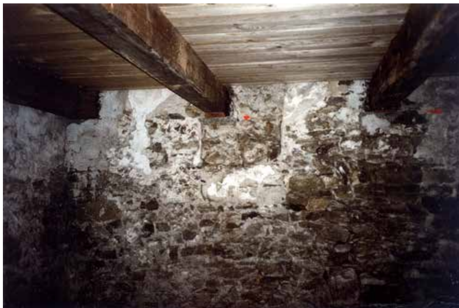
Obr. 17. Pohled od severu na zazděné okénko v přízemí západní části jižní stěny v jižní místnosti. Foto B. Nechvátal.
