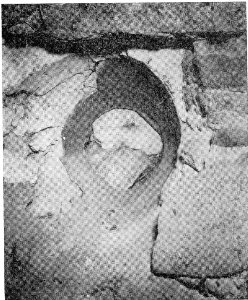
Obr. 6. Ostřetice (okr. Klatovy), čp. 14. Zbytek zazděné nádoby ve zdivu sýpky.
