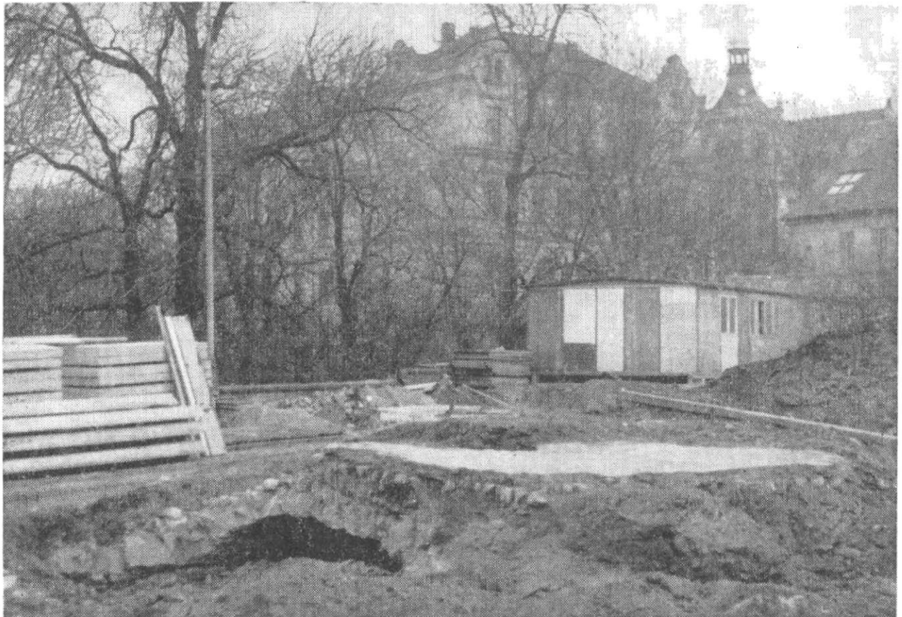
Obr. 9. Praha 6, Bubeneč, Kolkova ulice čp. 6 (demolice). Klenba sklepa a pohled na zkoumanou plochu od JZ. Foto: V. Huml.
