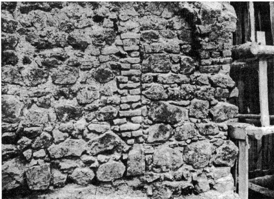
Obr. 7. Brno, Mečová ul. 2. Detail vnitřního líce V zdi suterénu I s pásem cihelného zdiva, pohled z V.
