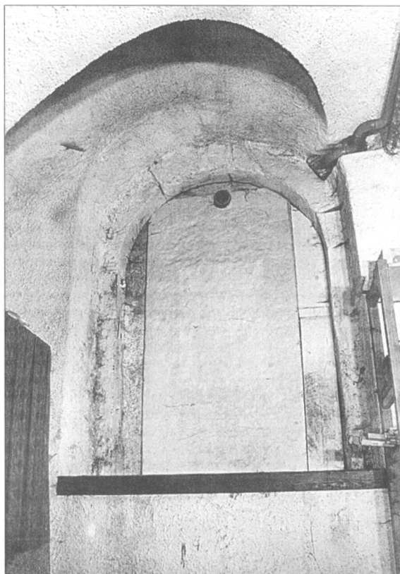
Obr. 5. Ivančice (okr. Brno-venkov). Dům č. p. 196 (tzv. dům panů z Lipé). Interiér severního sklepa. Foto J. Doležal, říjen 2001.
