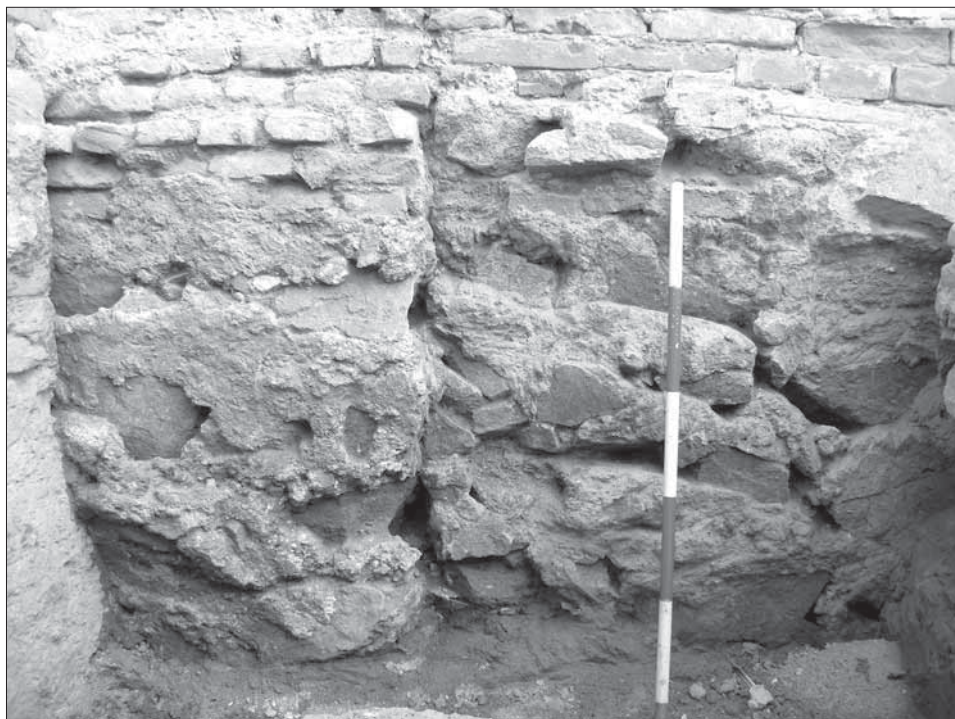
Obr. 12. Exteriér. Dilatačná škára v základovom múre lode kostola (sonda 16). Foto P. Grznár. Abb. 12. Außenbereich. Dehnungsritze in der Fundamentmauer des Kirchenschiffs (Sonde 16). Foto P. Grznár.
