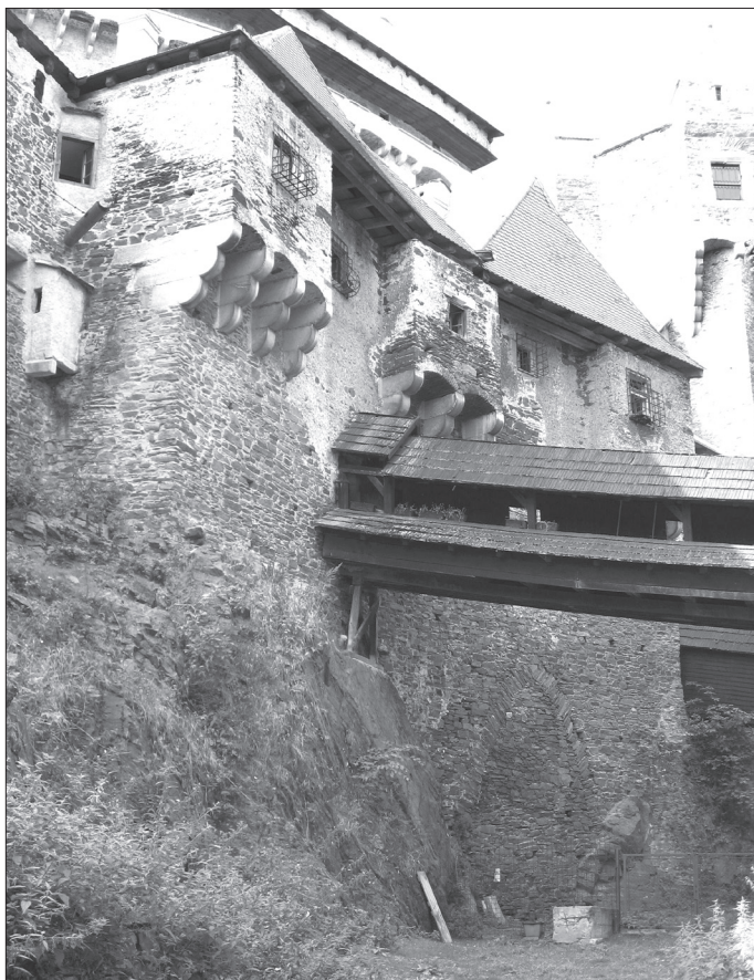
Obr. 6. Hrad Pernštejn; vnější průčelí objektu purkrabství, pohled od severovýchodu; nahore trojice arkýřů, pod nimi novodobý, krytý most v místech starší konstrukce, napravo dole patrný průběh hrotitého vylehčovacího pasu v plném zdivu trnože purkrabství.
