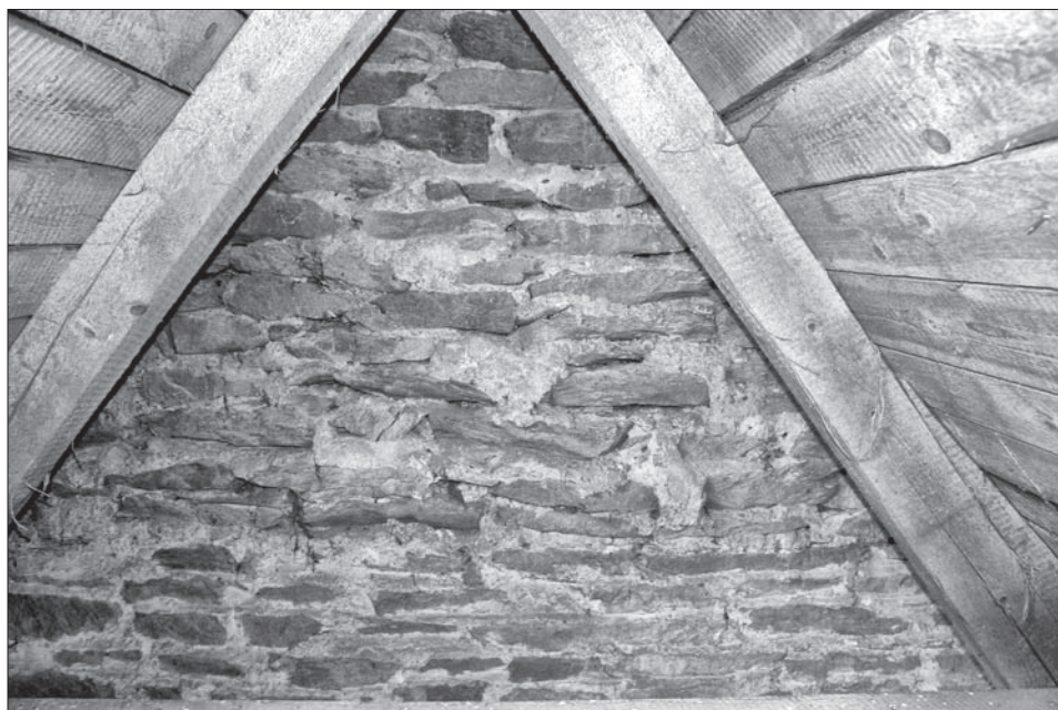
Obr. 3. Pařížov, kostel sv. Máří Magdalény. Pohled z púdy lodi na horní část východního průčelí věže, nad úrovní hambalků krovu, kde líc zdíva není povrchově upraven. Foto J. Varhaník, 2007.
