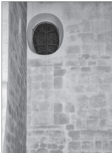
Obr. 8. Bukovec, okr. Domažlice, kostel Nanebevzetí Panny Marie. Portál na tribunu v západní stěně lodi. Vpravo patrná trhlinka vzniklá při odbourání jižní stěny lodě. Foto M. Čechura, 2009.
