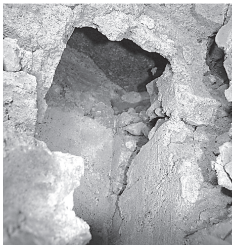
Obr. 10. Hrad Grabštejn, okr. Liberec. Dutina po vyhnílém trámu. Foto I. Peřina. Abb. 10. Burg Grafenstein (Grabštejn), Bezirk Liberec. Von einem morschen Balken stammender Hohlraum. Foto I. Peřina.
