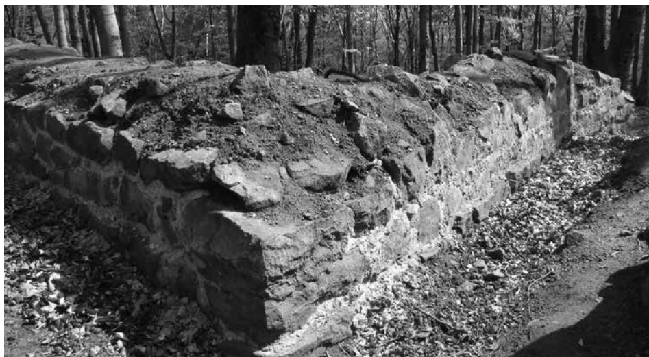
Obr. 12. Starý Světlov, k. ú. Podhradí u Luhačovic, okr. Zlín. Ukázky zakonzervovaného zdiva, opatřeného ochrannou nadezdívkou. A – severozápadní úsek hlavní hradby jádra, pohled od východu, uprostřed partie líce, kladená nasucho (Vrla 2014). B – západní nároží zřícenin paláce, pohled od západu (Vrla 2014).
