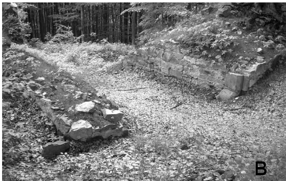
Obr. 5. Křídlo, k. ú. Brusné, okr. Kroměříž. A – zříceniny vstupní, hranolové věže od jihozápadu, stav v roce 2005 po dlouhodobé postupné destrukci. B – tatáž partie po konzervaci (Vrla 2006). Abb. 5. Křídlo, Katastergebiet Brusné, Bezirk Kroměříž. A – Ruinen des Prismenurms am Eingang von Südwesten, Zustand im Jahr 2005 nach langanhaltendem Zerfallsprozess. B – dieselbe Partie nach der Konservierung (Vrla 2006).
