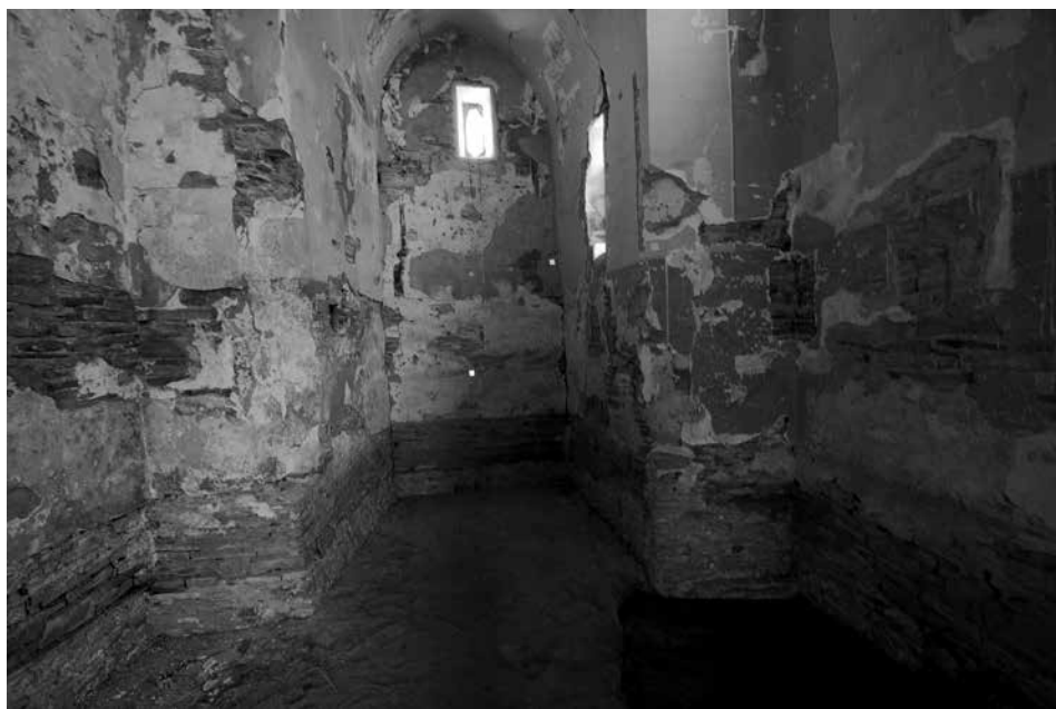
Obr. 4. Kopčany, okr. Senica, Kostol sv. Margity Antiochijskej. Východná stena po odkryvoch so zvyškami iluzívnej výzdoby. Abb. 4. Kopčany, Bezirk Senica, Kirche St. Margaretha von Antiochien. Ostwand nach den Freilegungen mit Resten der illusionistischen Verzierung.
