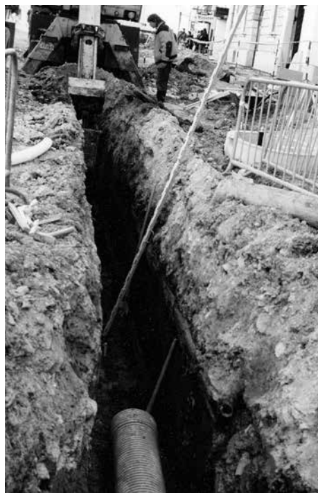
Obr. 14. Banská Bystrica. Námestie Š. Moysesa č. 5–8. Porušené drevené potrubie vodovodu z prevrtaných rúr. Foto M. Mácelová.
