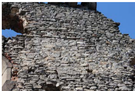
Obr. 17. Hrad Slanec, okr. Košice-okolie. Detail severovýchodnej steny paláca so zamurovaným cimburím a trámov ochodze. Foto M. Šimkovic.
