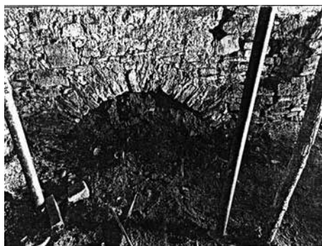
Obr. 9. Záklenek v západní části severní stěny v severní místnosti, na pravé straně výrazná hluboká spára. Foto J. Hloch et. al.
