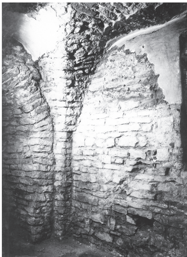
Obr. 12. Bazilika sv. Vavřince – pohled od západu na závěr severní apsidy s původní klenbou. Foto B. Nechvátal.
